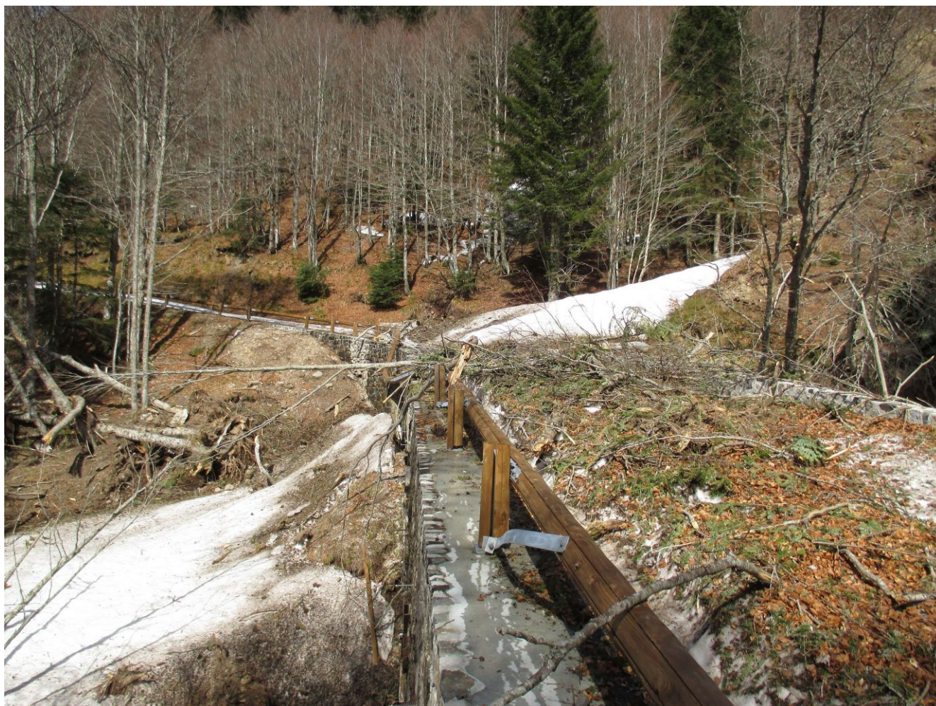
Figure 17: Dégâts sur la RD680 au PK 48,5 à la fin de l'hiver 2014-2015, sous la face Ouest du Puy Mary. Photo conseil départemental.
