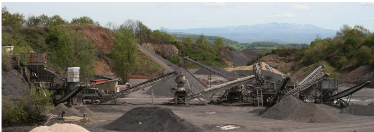
Installations de concassage-criblage
