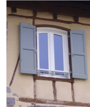
Battée centrale trop large
