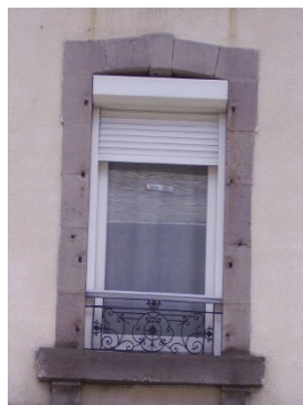
Caisson de volets roulants à l'extérieur
