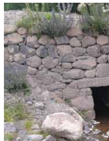
Photographie n°4 : Ouvrage hydraulique en chemin de Murat à Allanche
