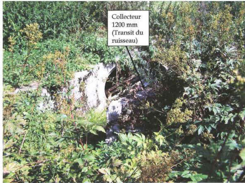
Photographie n°3 illustrant le passage du ruisseau de la Gazelle sous la masse de déchet grâce à un collecteur de diamètre 1200 mm
