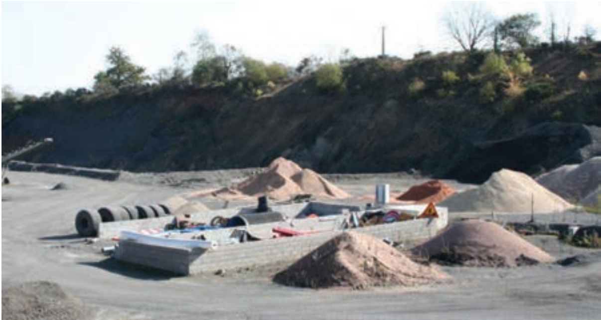
Les cuvettes de rétention pour les cuves d'hydrocarbures utilisées lors de la présence de la centrale d'enrobage
