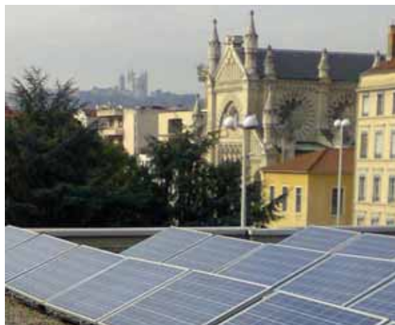
Photovoltaïque sur l'hôtel communautaire du Grand Lyon.
